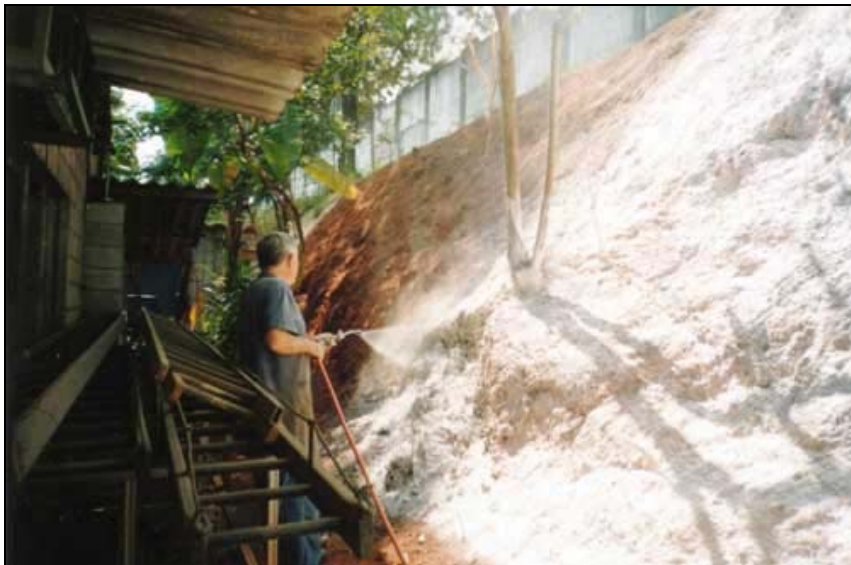
Pulverizador motorizado - primeira demão sendo aplicada com o auxílio de mangueira que pode ter a extensão de até 30 metros
